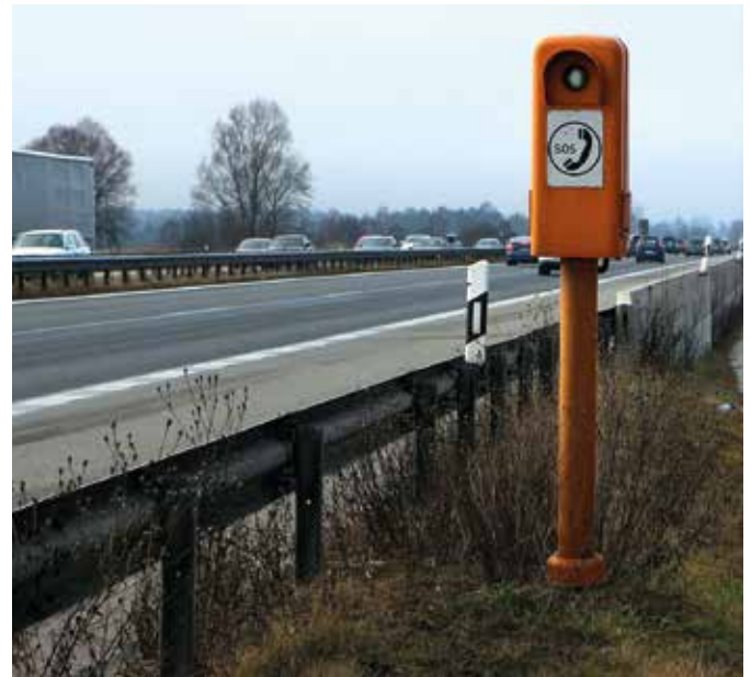
Alle zwei Kilometer steht eine Notrufsäule an der Autobahn. Ein Pfeil und eine Zahl auf den Leitpfosten geben Richtung und Abstand an. Foto: Antranas/pixabay.com/mid/ak
